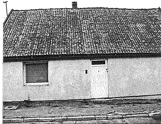
Rys. 7. Pokrycie dachowe ocenione w II stopniu pilności (źródło własne).
