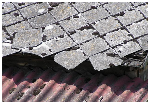
Rys. 8. Pokrycie dachowe ocenione w I stopniu pilności.
