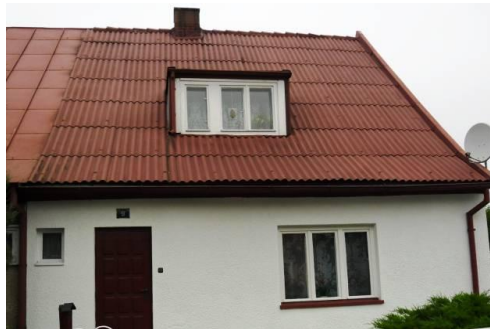
Rys. 6. Pokrycie dachowe ocenione w III stopniu pilności.
