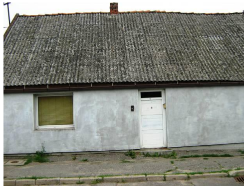
Rys. 7. Pokrycie dachowe ocenione w II stopniu pilności.
